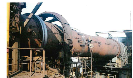
産廃焼却設備 (塩化揮発ロータリーキルン)
