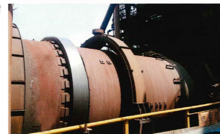
産廃焼却設備 (産廃キルン)
