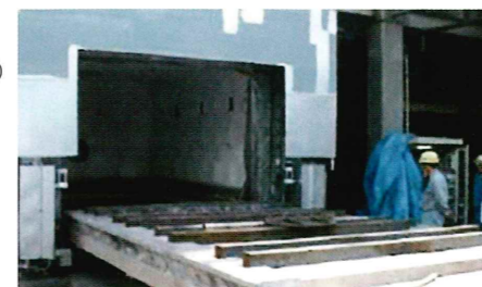
固定床炉 (産廃処理、 低濃度PCB処理)
