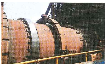
産廃焼却設備 (産廃キルン)
