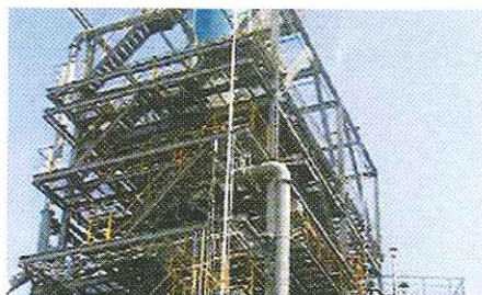
産廃焼却設備 (二次燃焼炉)
